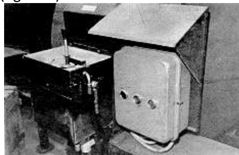
Fig. 5: Interruptores exteriores protegidos de la lluvia y caída de materiales
